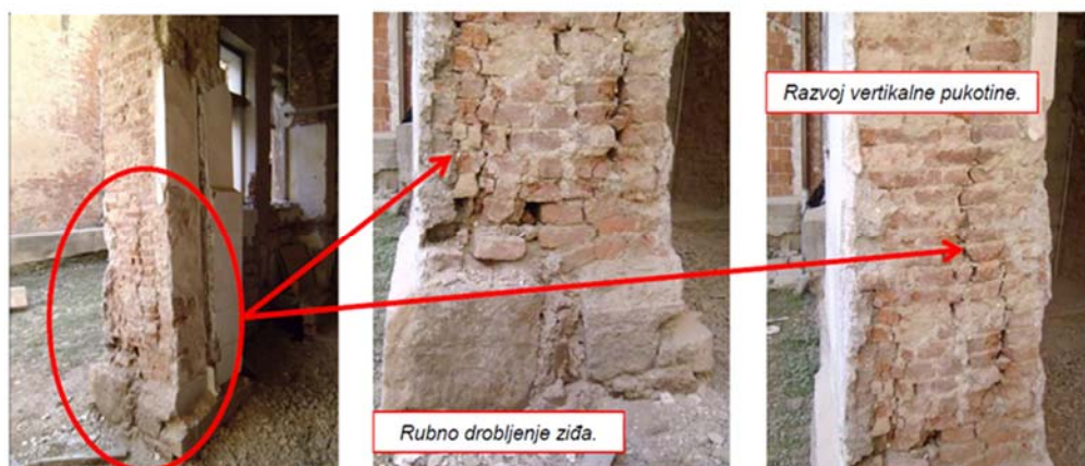
Slika 2.38 Oštećenje zidanih stupova
