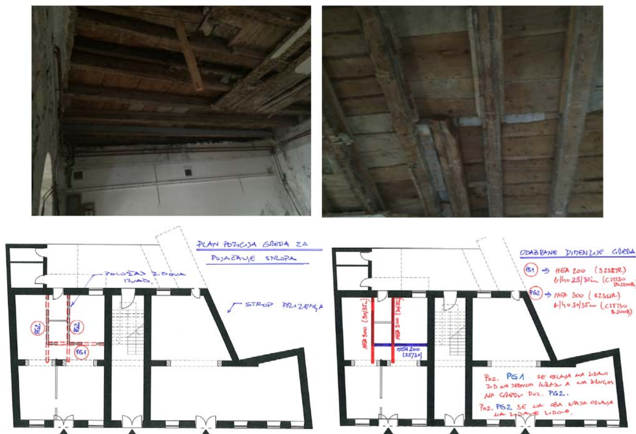
Slika 3.19 Prikaz stropa s vidljivim pregradnim zidom bez potrebnog oslonca (gore) i skice rješenja s čeličnim gredama
