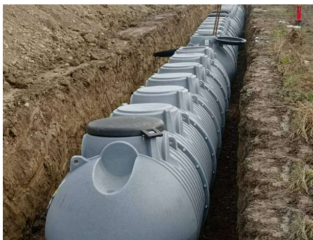
Sl. 2-5 Ukopani spremnik [Aquos]
