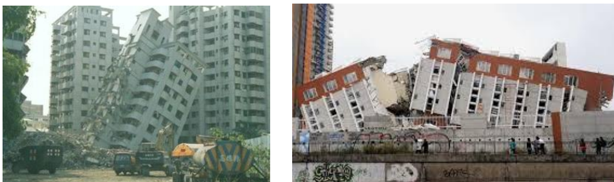
Slika 1.18. Fotografija urušavanja građevina uslijed djelovanja potresa
